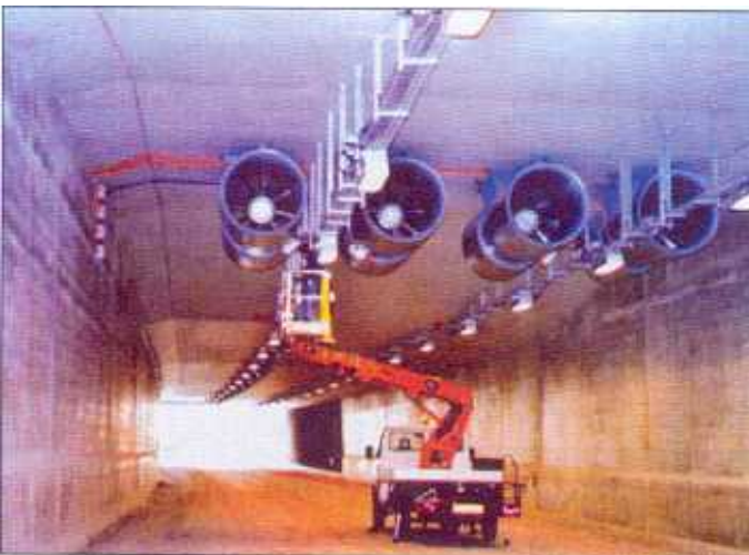
Aufhängekonstruktion eines Strahllüfters. Es ist Aufgabe der Planer, genau zu bestimmen, welche Bauteile einer Aufhängekonstruktion aus welchen Materialien zu fertigen sind.
